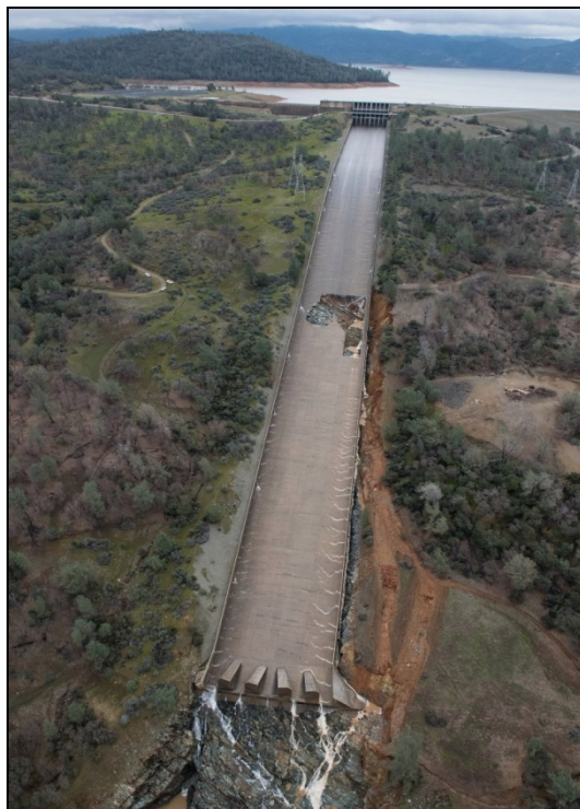
Imagen 5: Vista del aliviadero principal de la presa con el incipiente socavón en su zona central.
