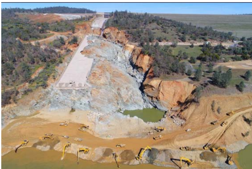
Imagen 7: Estado final del aliviadero principal de la presa de Oroville tras el incidente (27/02/2017).
