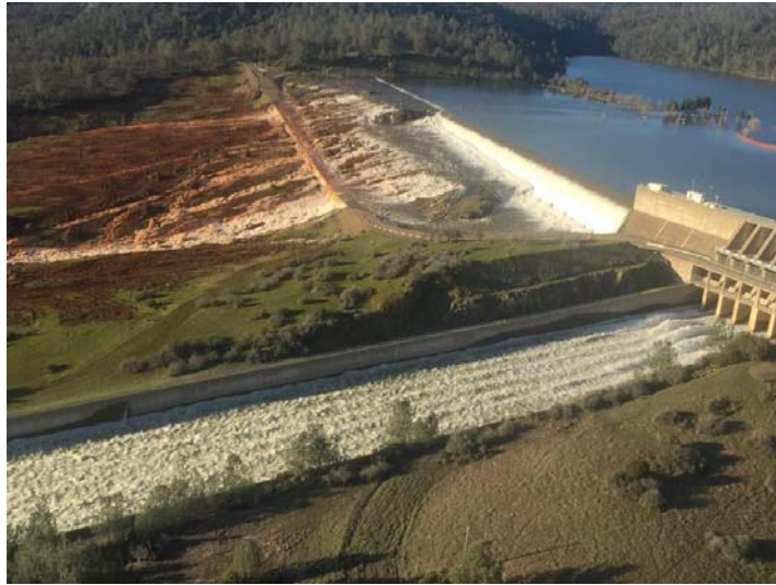
Imagen 2: Aliviadero principal (en primer término) y aliviadero de emergencia. La erosión en la ladera aguas abajo del aliviadero de emergencia es evidente.
