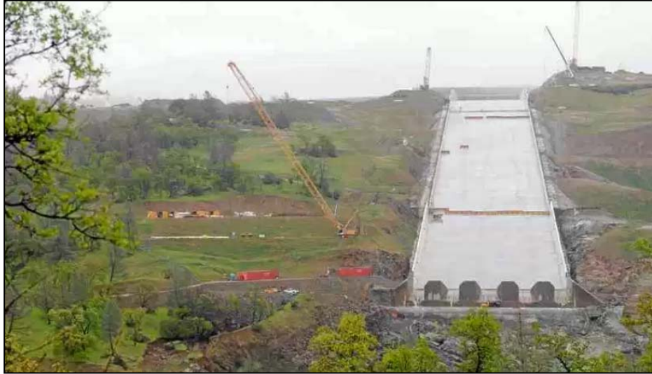
Imagen 8: Estado del aliviadero principal de la presa de Oroville en febrero de 2018. Pese a que su estado parece “casi” normal, aún queda mucho trabajo por hacer.
